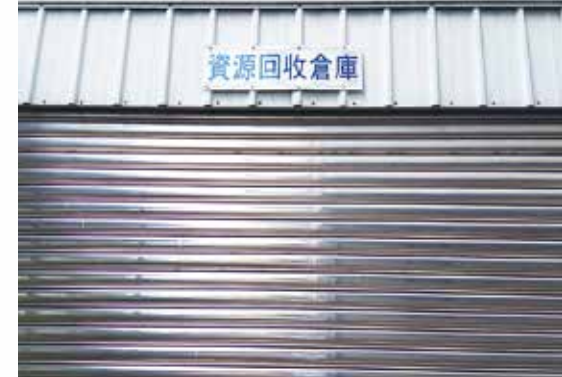
廢棄物分類收集，依標示落實妥善管理。
